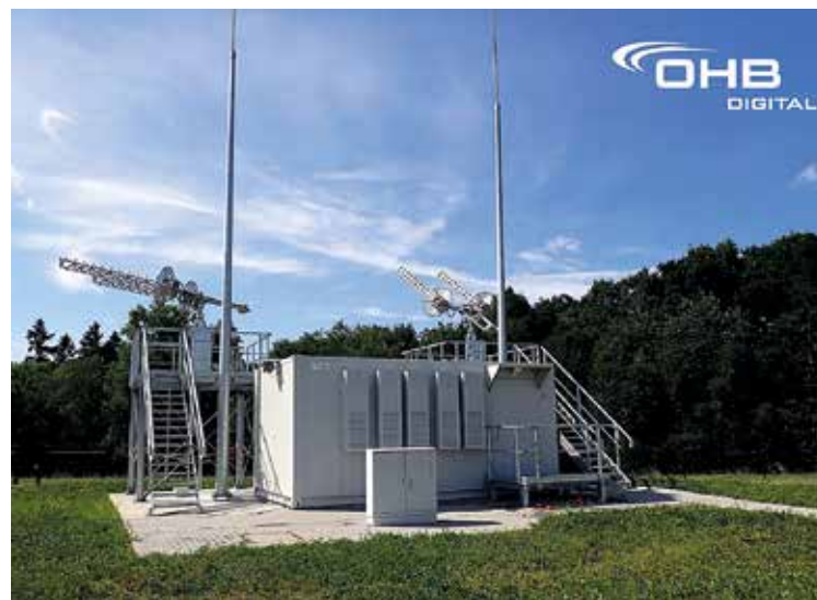
Die neue UHF-Kontrollstation ist Teil des Programms SATCOMBw.
